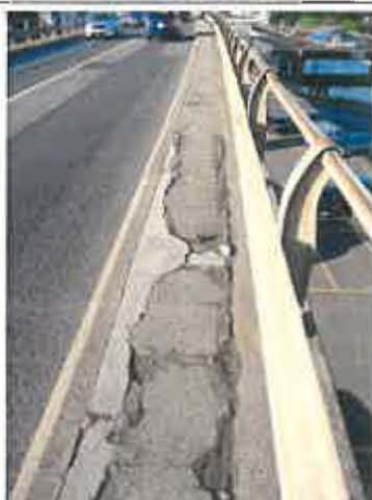
TrDr Trottoir Droite 141 Revêtement de finition disparaissant (usure) général Dégâts répartis tout le long du trottoir
