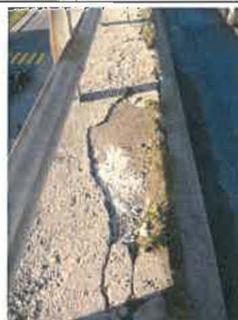
TrGa Trottoir Gauche 141 Revêtement de finition disparaissant (usure) général Dégâts répartis tout le long du trottoir
