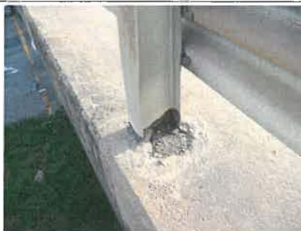
GlDr Glissière Droite 2209 Parties corrodées axe 21 Pied de la Glissière présentant de la rouille
