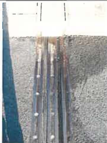
Jo10 Joint de chaussée, axe 10 319 Joint non étanche Côté droit + côté gauche + face supérieure joint non étanche, apparition de zones humides, de tâches de rouille et fissuration des bords de dalle
