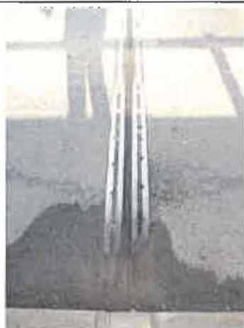
Jo16 Joint de chaussée, axe 16 319 Joint non étanche Côté droit + côté gauche + face supérieure joint non étanche, apparition de zones humides, de tâches de rouille et fissuration des bords de dalle
