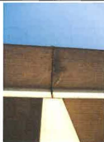
Jo5 Joint de chaussée, axe 5 319 Joint non étanche côté gauche joint non étanche, apparition de zones humides, de tâches de rouille et fissuration des bords de dalle
