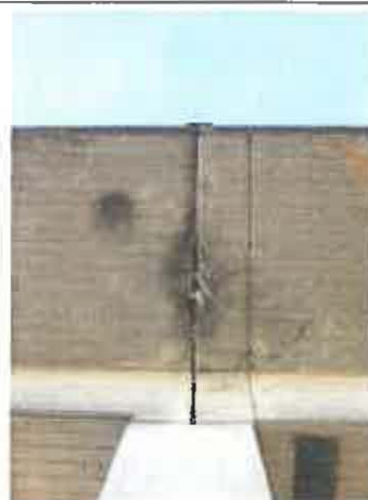
Jo15 Joint de chaussée, axe 15 319 Joint non étanche Côté droit + côté gauche + face supérieure joint non étanche, apparition de zones humides, de tâches de rouille et fissuration des bords de dalle
