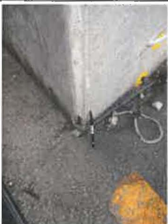
Pi19 Pile, axe 19 2204 Armature légèrement corrodée Pied de pile Béton d'enrobage insuffisant
