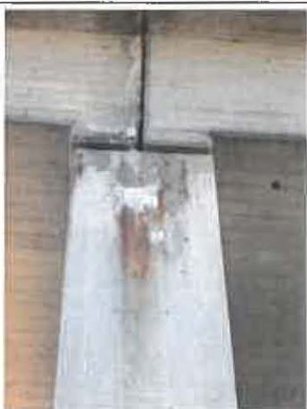
Pi10 Pile, axe 10 2203 Taches de rouille Face droite supérieure Apparition de tâches de rouille dues à la non étanchéité du joint Jo10
