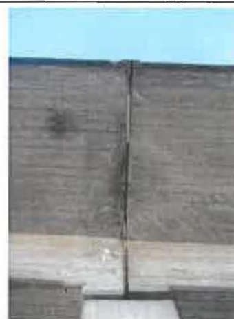
Jo18 Joint de chaussée, axe 18 319 Joint non étanche côté droit + côté gauche joint non étanche, apparition de zones humides, de tâches de rouille et fissuration des bords de dalle
