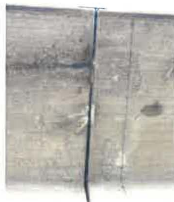
Jo16 Joint de chaussée, axe 16 319 Joint non étanche Côté droit + côté gauche + face supérieure joint non étanche, apparition de zones humides, de tâches de rouille et fissuration des bords de dalle
