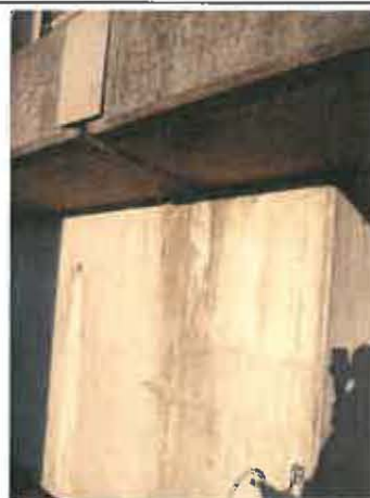
CuGa21 Mur en aile gauche, axe 21 301 Zones humides milieu de l'objet sous tablier Zone humide due à l'écoulement venu du tablier
