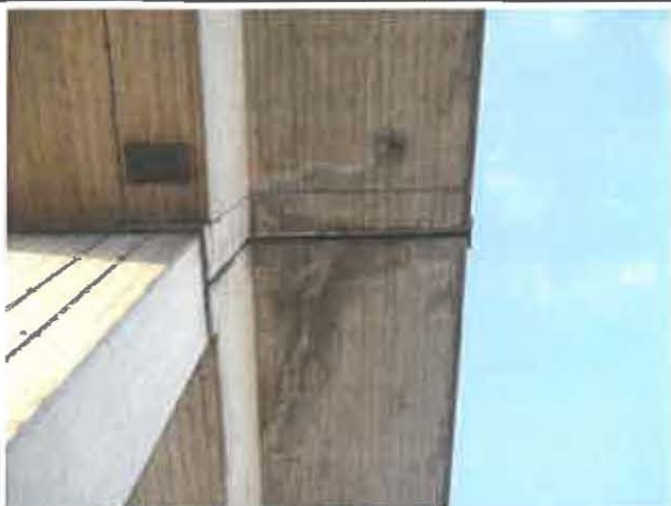
Jo16 Joint de chaussée, axe 16 319 Joint non étanche Côté droit + côté gauche + face supérieure joint non étanche, apparition de zones humides, de tâches de rouille et fissuration des bords de dalle
