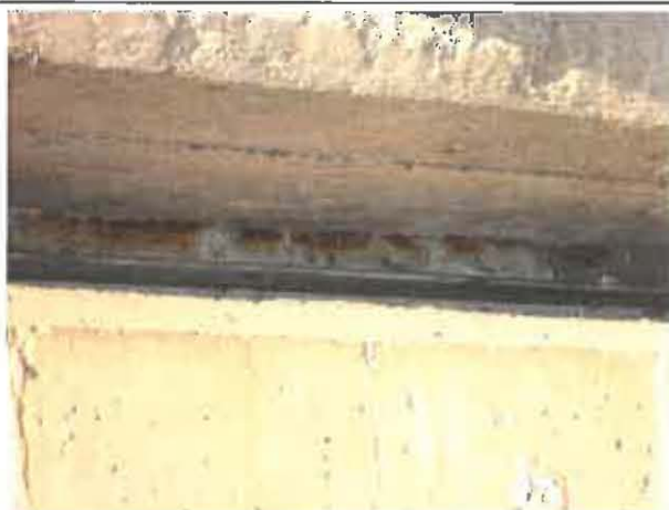
Ap21-01 Appareils d'appui axe 21 408 Aptitude au fonctionnement réduite Axe21 Présence de rouille
