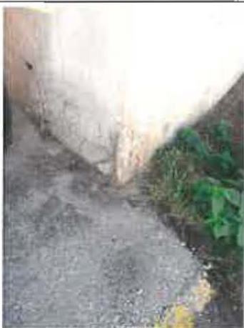
Cu21 Culée, axe 21 2204 Armature légèrement corrodée Pied de culée côté Droit armature apparente et légèrement corrodée dans l'angle droit
